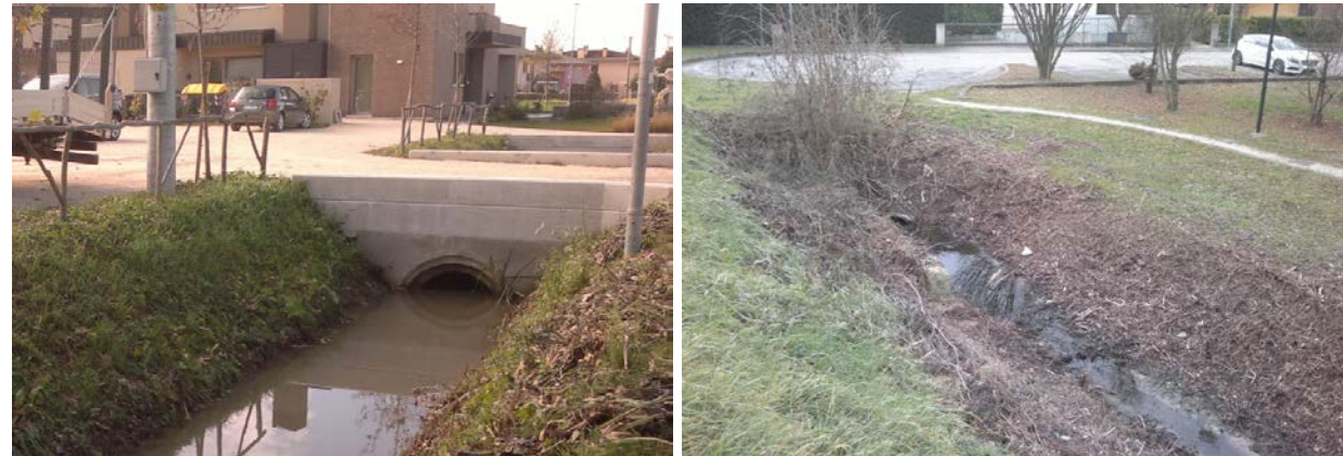
A sinistra un esempio di ponte da rifare lungo il fosso di via Ca' Bembo, a destra fosso che necessita intervento di spurgo all'altezza di via Circonvallazione
