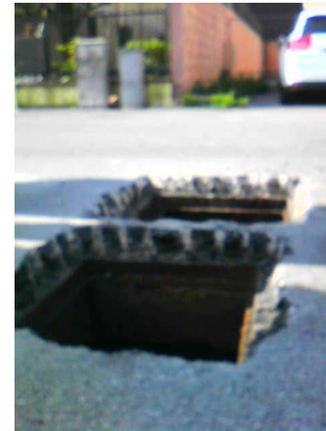
Via Primo Maggio: assenza di ispezioni
