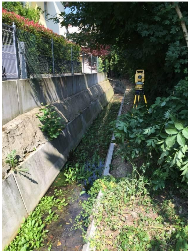
Foto 6 : Ambito Est - Fossato realizzato con canaletta in c.a. a valle del tombinamento.
