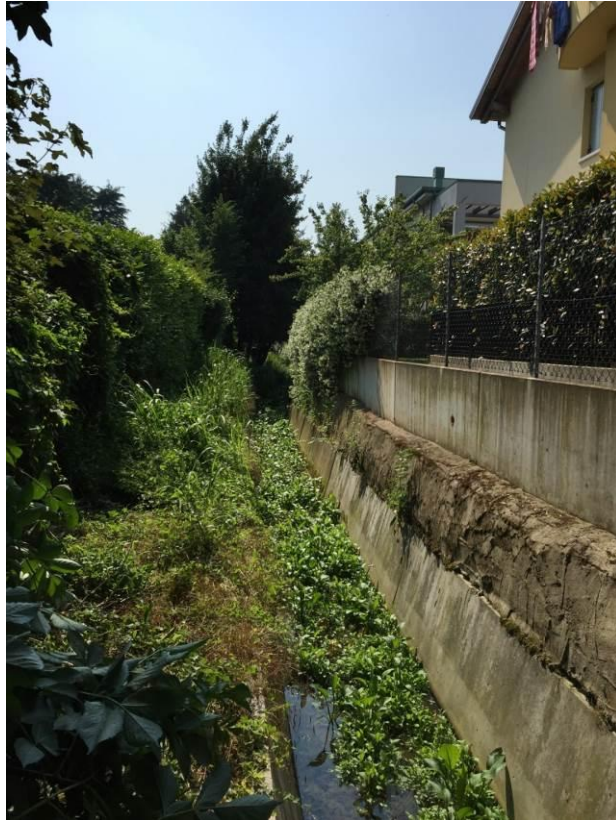
Foto 5 : Ambito Est - Fossato realizzato con canaletta in c.a. a valle del tombinamento.
