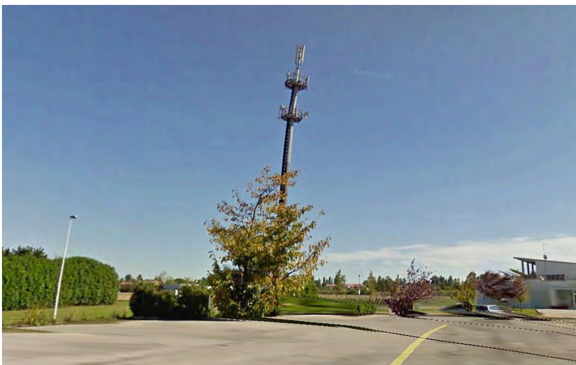
Figura 4-1: Antenne per telefonia mobile installate su palo presso gli impianti sportivi di Maerne
